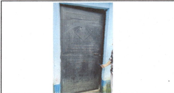
FOTO 5: Mantenimiento a estructura (lijado, lijado de tubo, cepillado, sujeciones, aplicación de pintura)
