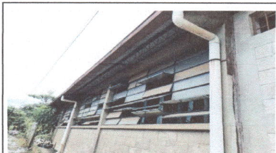
FOTO 7: Sustrucción de canal de metal en modulo de aula 5 6 7 8 9 10 y 11
