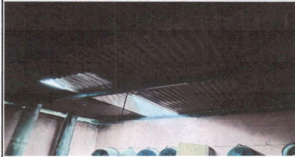
FOTO 1: Sustitución de lámina, por lámina troquelada aluzinc calibre 26 y sustitucion de estructura de madera por metal en modulo de cocina
